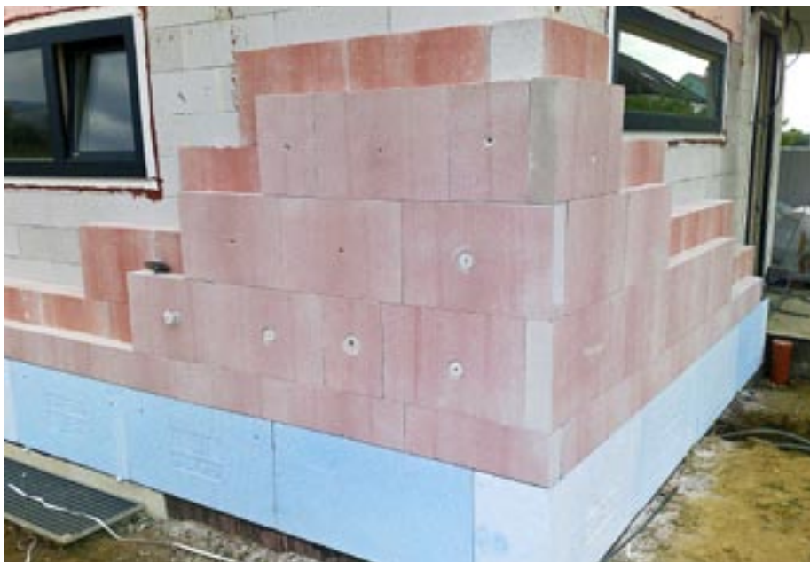
Der Wandaufbau des Passivhauses besteht aus 30 cm Ytong Thermoblock sowie 30 cm Multipor
